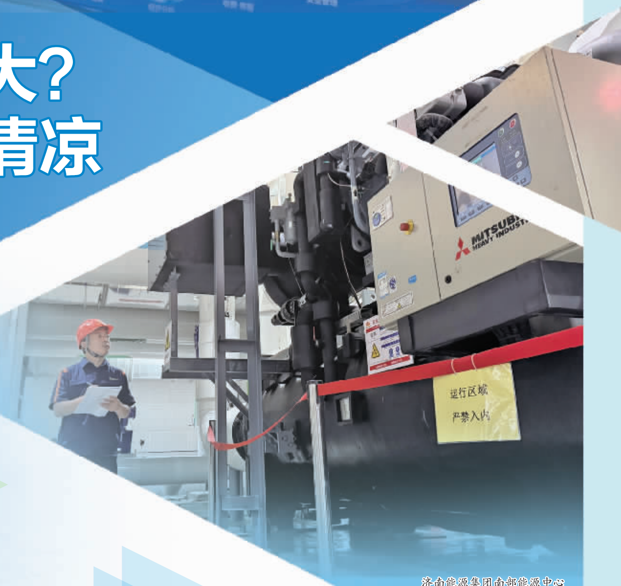
济南能源集团南部能源中心
